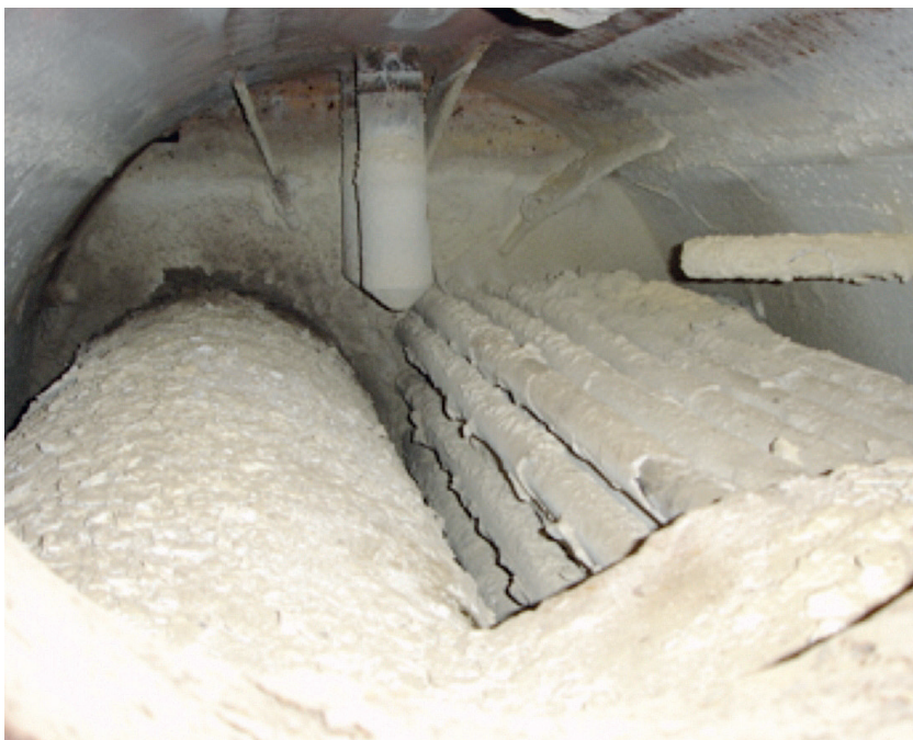
Rysunek 1: Wskutek braku odpowiedniego przygotowania wody odłożył się kamień, który w skrajnych okolicznościach może doprowadzić do wybuchu kotła.
